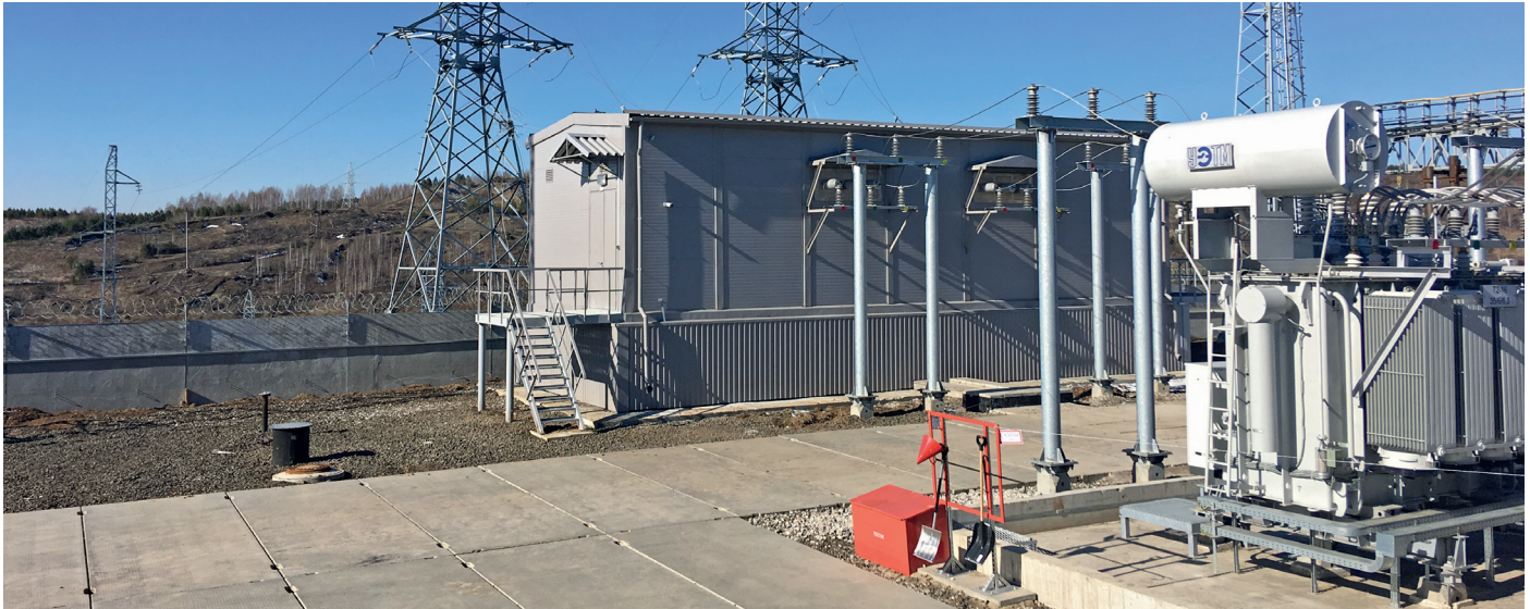
Кемеровская область. Подстанция «Сычёвская». Контроль перегрева кабелей.
