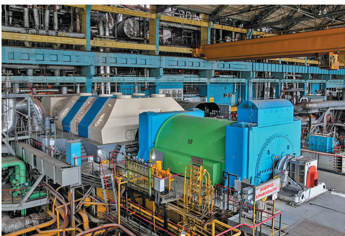
Свердловская область. Среднеуральская ГРЭС.
